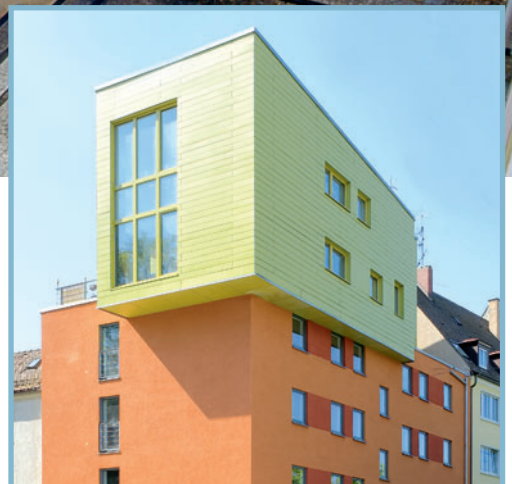
Einsatz von Diamant-Platten bei der Sanierung und Penthouse-Aufstockung in Holzbauweise. Das Diamant-Trockenbausystem wirkt dabei statisch aussteifend.
